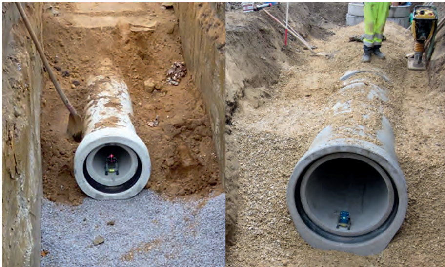
Abb. 2: Unsachgemäß bzw. fachgerecht: Unterschiedliche Materialien für die untere und obere Bettungsschicht (links) – Einheitliches Material für die Bettung (rechts)
