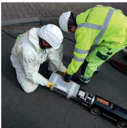
Die PI.TRON-Spachtel- und Verpress-Einheit wird für den Einsatz zur Reparatur eines Anschlusses vorbereitet
