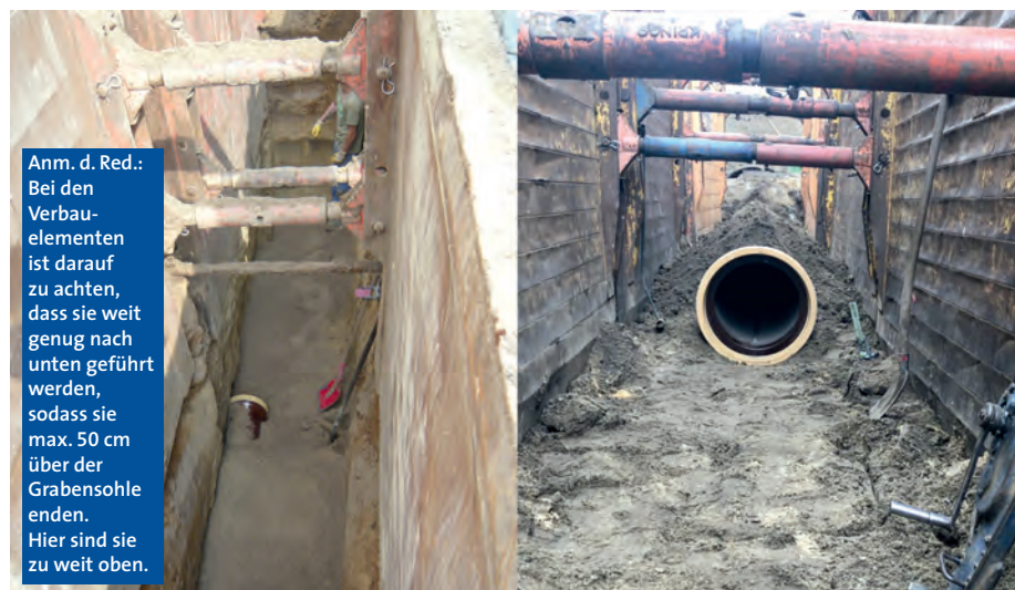
Abb. 1: Unsachgemäß bzw. fachgerecht: Die extreme Abweichung zwischen Rohr- und Verbauachse macht eine fachgerechte Herstellung der Bettung und der Zwickelverdichtung nicht möglich (links) – Einbau des Rohres mit beidseitig gleichem Arbeitsraum gemäß Regelwerk (rechts)
