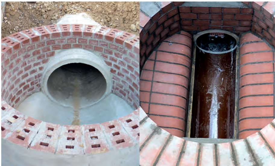
Abb. 3: Unsachgemäß bzw. fachgerecht: Verwendung unzulässiger Klinker (links) – Fachgerecht hergestelltes Schachtunterteil (rechts)
