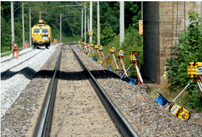
Abb. 8: Einsatz des neuen ZPW 126-31
