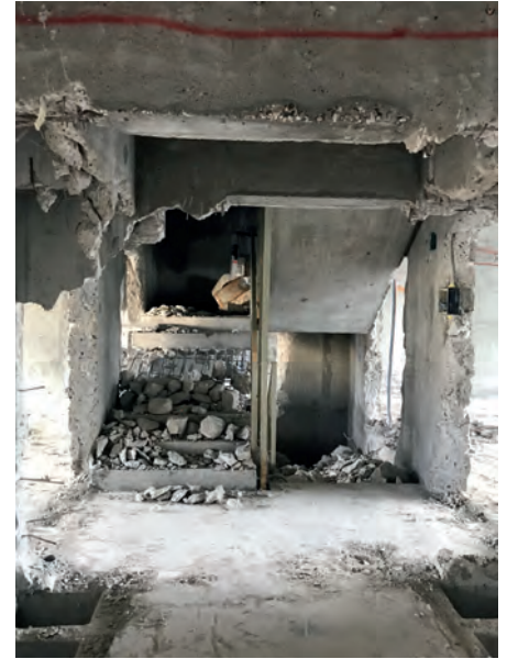
Abb. 4: Vorgeschwächte Bauwerksteile im Obergeschoss
